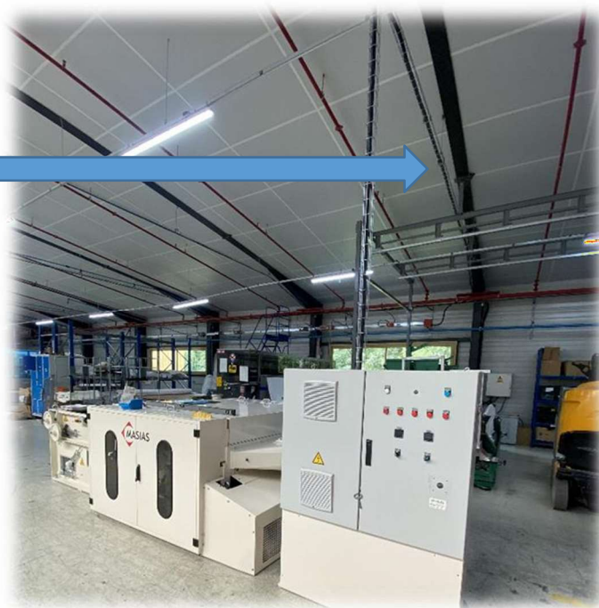
Figure 30 : chemins de câble
